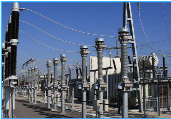
Subestación elevadora, España.
